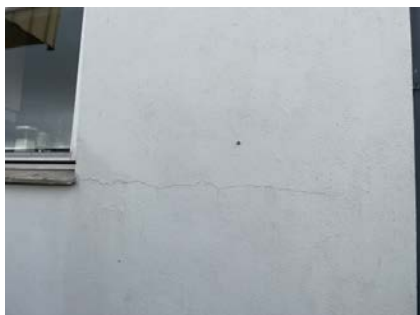
Eksempel på riss/ sprekk i fasader.
