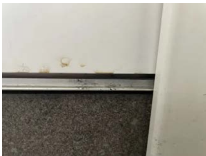
Manglende silikonfuge mellom baderomsplater og sokkelprofil.
