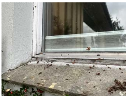
Foto viser eksempel på råte i karm/ ramme og manglende beslag ved innpussing.
