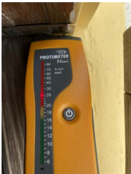
Forhøyet fuktnivå i karm på vindu.
