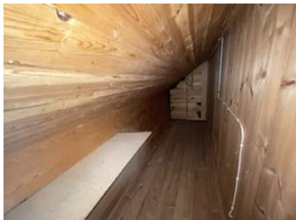
Kott med begrenset tilkomst av takkonstruksjon, forbehold om skjulte feil og mangler.
