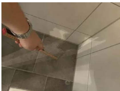
Markerer hvor bom under flis er påvist på gulv i dusjsonen.
