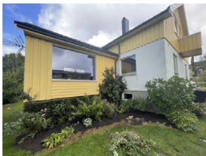
Foto viser vegetasjon inntil konstruksjoner.
