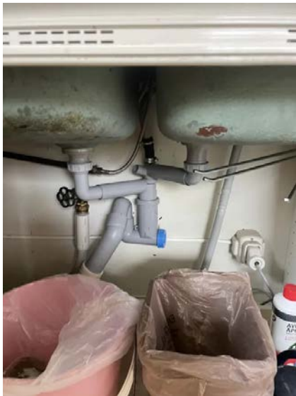
Synlige vann og avløpsrør i kjøkkenvask.
