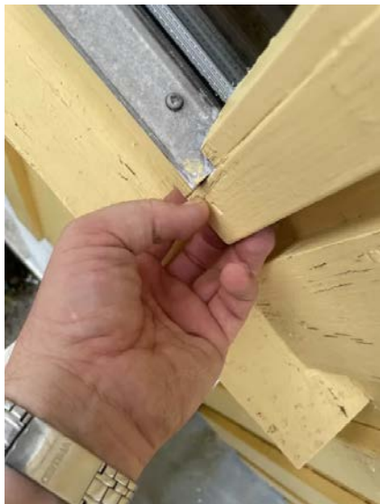
Eksempel på nedbrytning i karm/ ramme, noe malingsavskallinger på vinduet.
