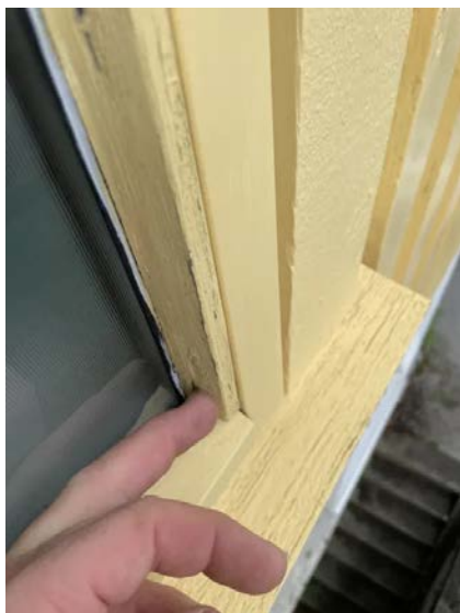
Råte i glasslister.
