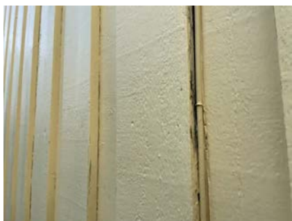
Foto viser eksempel på spredt råte i kledning.
