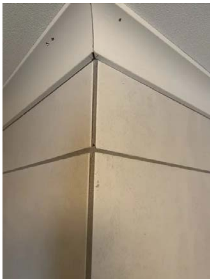
Sprekk i flisfuge.
