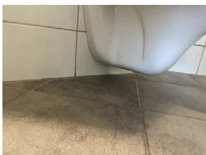
Ingen tegn til lekkasjesikring under vegghengt toalett.
