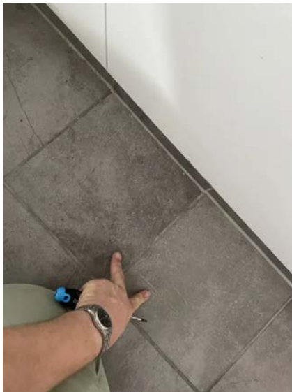
Bilde markerer hvor bom er påvist, kan ikke utelukkes øvrige fliser med bom i rommet.
