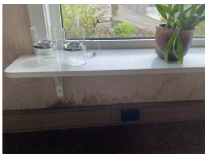
Innvendige fuktmerker på vegg, kan ha sammenheng med utvendig vegetasjon, ytterligere undersøkelser må påregnes av lukkede konstruksjoner.
