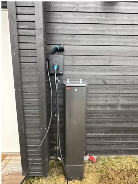
Viser utvendig målerskap og elbillader.
