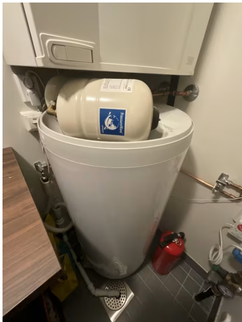
Viser bereder plassert på teknisk rom.
