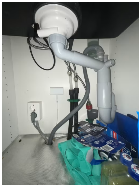
Viser vann og avløpsinnstallasjoner under kum.
