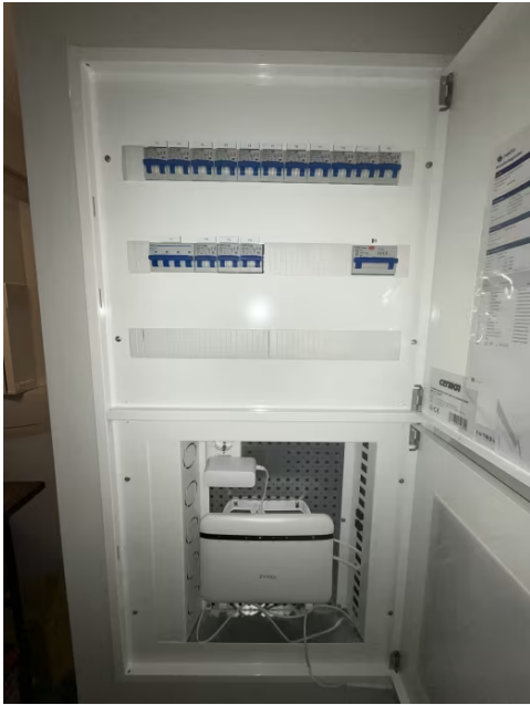
Viser innfelt sikringsskap med svakstrømdel.
