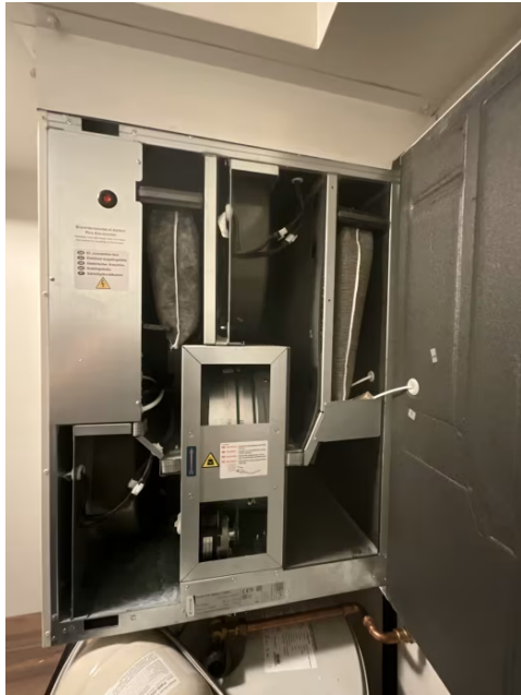
Viser balansert ventilasjonsaggregat innvendig.
