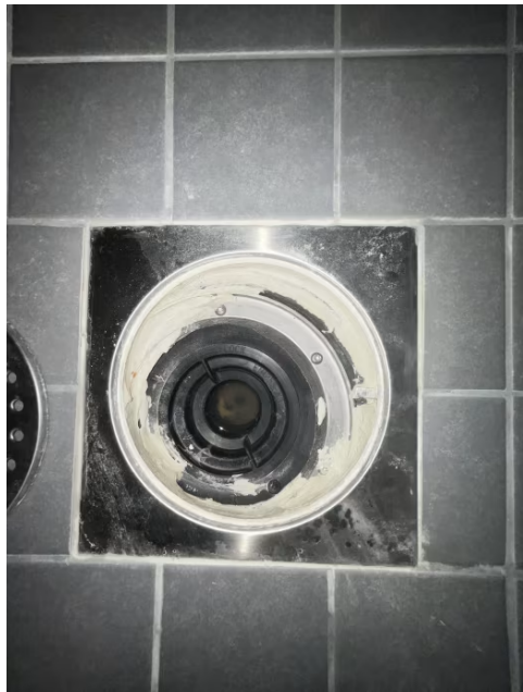
Viser sluk i dusjsonen.
