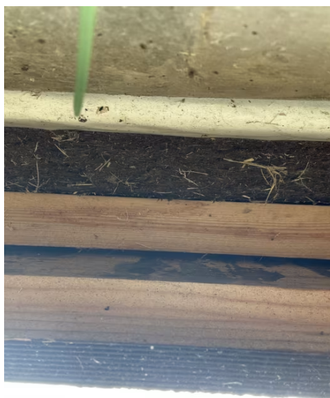
Det registreres manglende/dårlig lufting bak kledningen.
