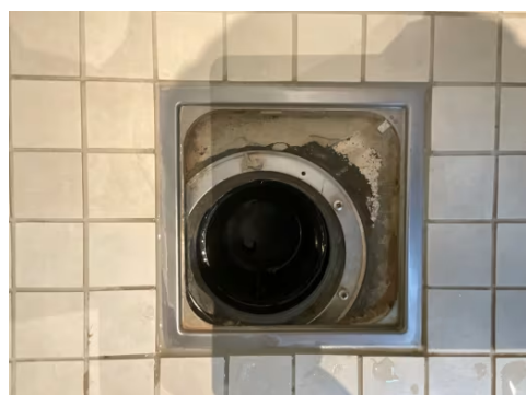
Viser sluk i dusjonen.
