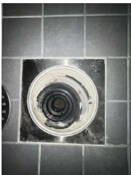
Viser sluk i dusjsonen.
