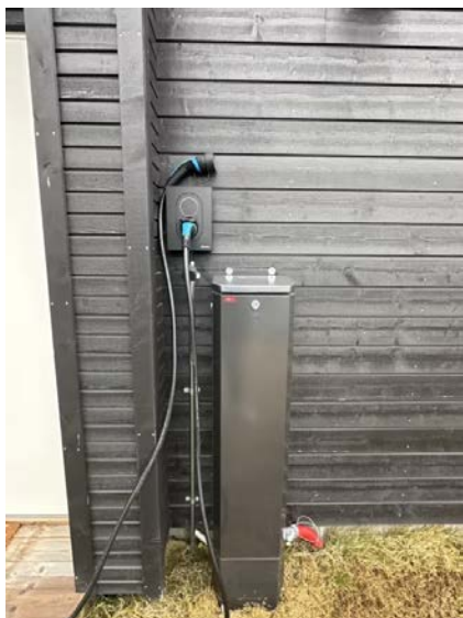
Viser utvendig målerskap og elbillader.
