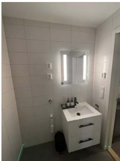
Viser baderomsinnredning og opplegg for vaskemaskin.
