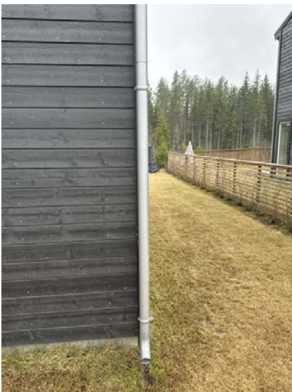
Viser nedløpsrør ført til terreng.
