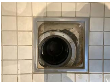
Viser sluk i dusjsonen.
