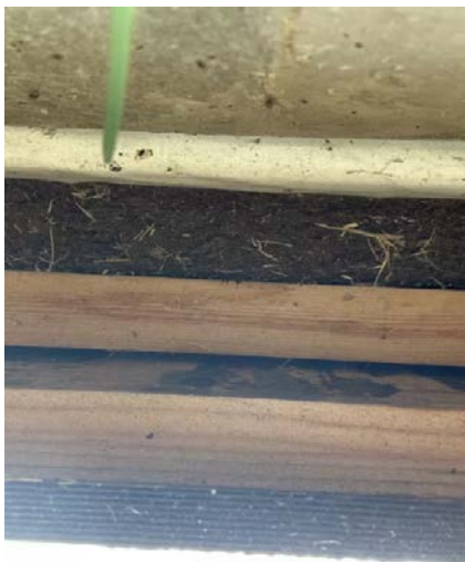
Det registreres manglende/dårlig lufting bak kledningen.
