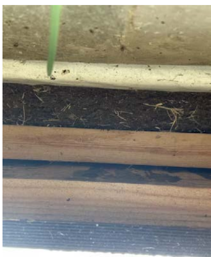
Det registreres manglende/dårlig lufting bak kledningen.
