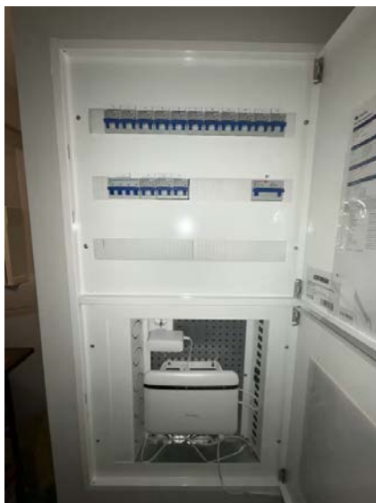
Viser innfelt sikringsskap med svakstrømdel.
