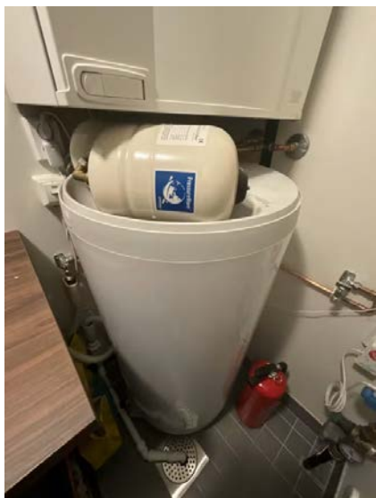
Viser bereder plassert på teknisk rom.
