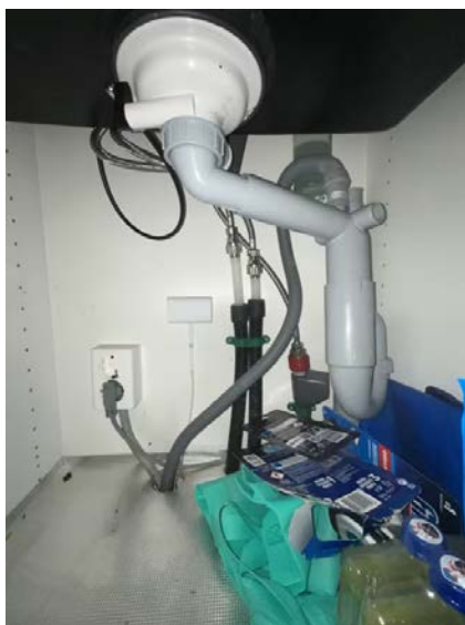
Viser vann og avløpsinnstallasjoner under kum.
