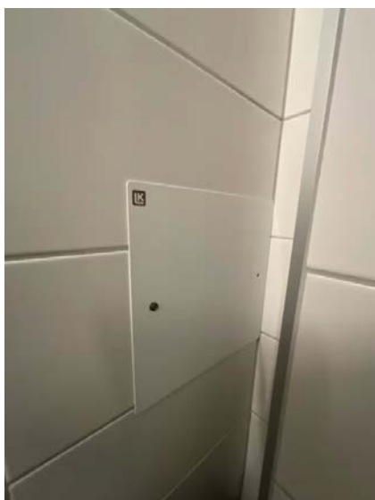
Viser innfelt skap på bad i 1.etasje, kobling til utekran. Lekkasjeføler i skap.
