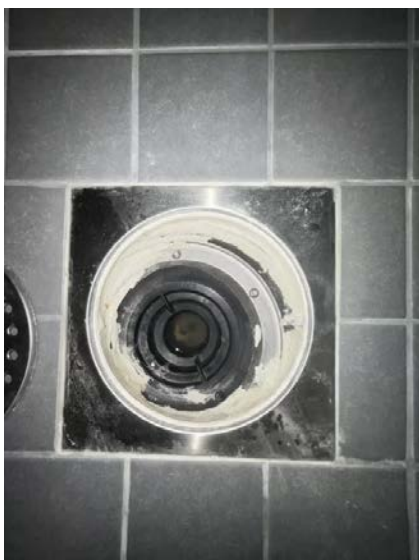
Viser sluk i dusjsonen.
