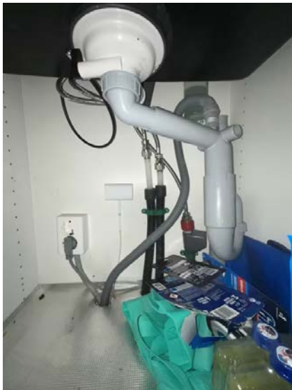
Viser vann og avløpsinnstallasjoner under kum.
