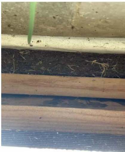
Det registreres manglende/dårlig lufting bak kledningen.
