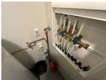
Viser vanninntak, hovedstoppekran og fordelerskap plassert på teknisk rom.
