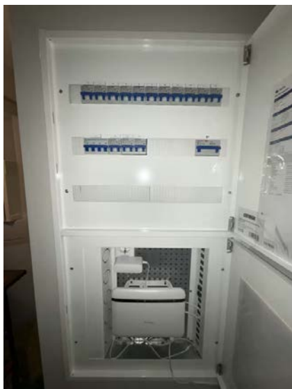
Viser innfelt sikringsskap med svakstrømdel.
