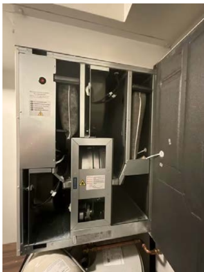
Viser balansert ventilasjonsaggregat innvendig.
