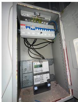
Sikringsskap med automatsikringer.
