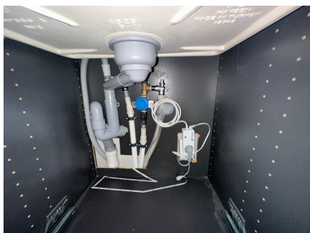
Røropplegg i kjøkkenbenk med Waterguard
