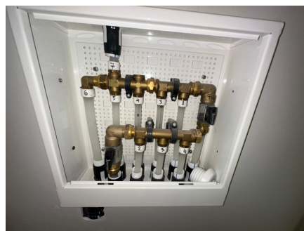
Samleskap med rørkurser og stoppekraner
