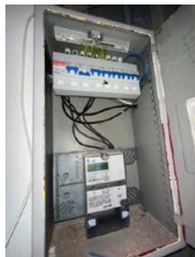
Sikringsskap med automatsikringer.
