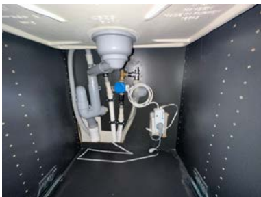
Røropplegg i kjøkkenbenk med Waterguard
