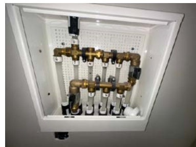
Samleskap med rørkurser og stoppekraner
