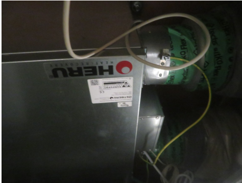
Balansert ventilasjons aggregat i himling på badet.
