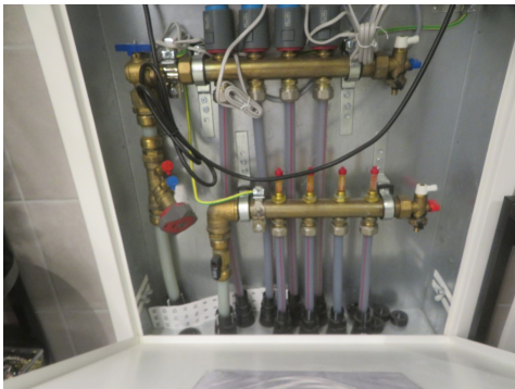
Styring for vannbåren gulvvarme.
