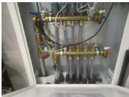
Styring for vannbåren gulvvarme.
