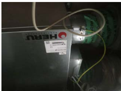
Balansert ventilasjons aggregat i himling på badet.
