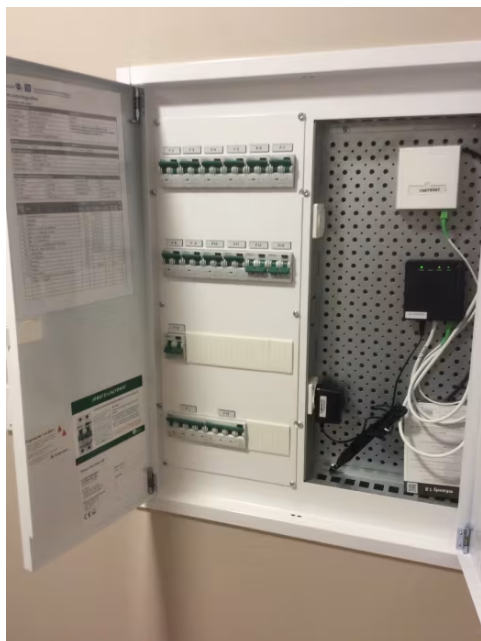
Sikringsskap plassert på vaskerom.
