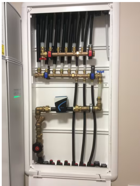
Vannskap plassert på vaskerom.
