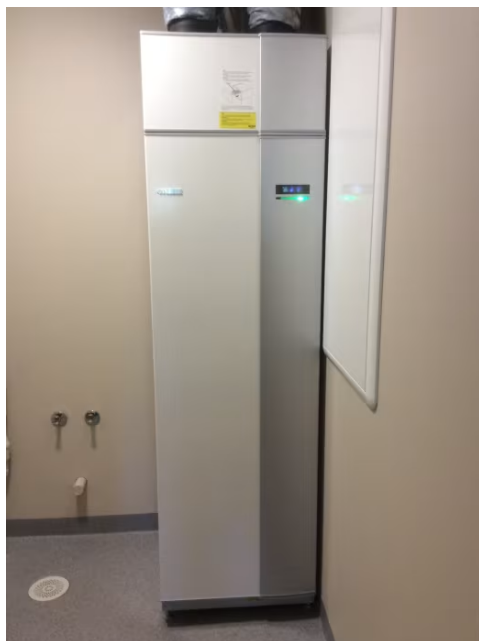
Ventilasjonsanlegg, varmepumpe og bereder montert i Nibe avtrekksvarmepumpe.
