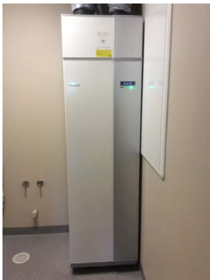
Ventilasjonsanlegg, varmepumpe og bereder monterert i Nibe avtrekksvarmepumpe.
