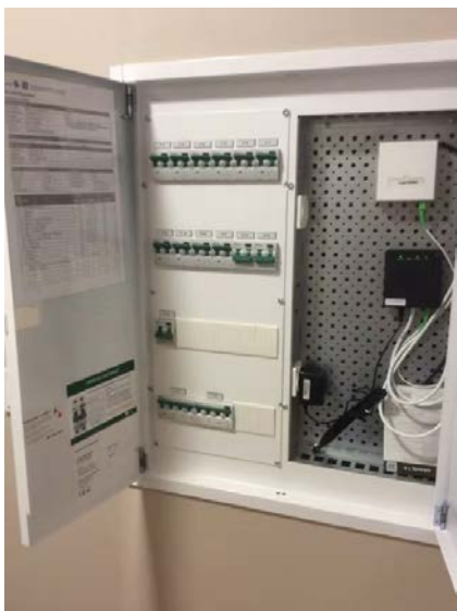
Sikringsskap plassert på vaskerom.
