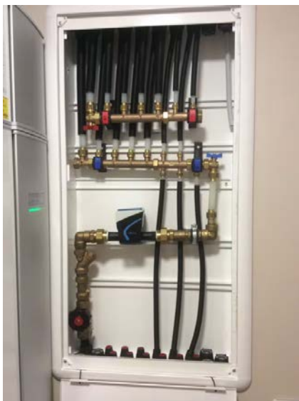
Vannskap plassert på vaskerom.
