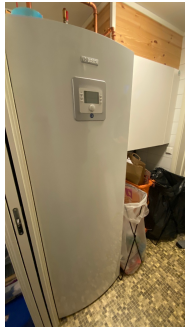
Innedel med varmtvannsbereider plassert i teknisk rom
