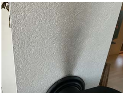
Foto viser synlig indikasjon på mindre lekkasje ved gjennomføringspunkt for ovnsrør.
