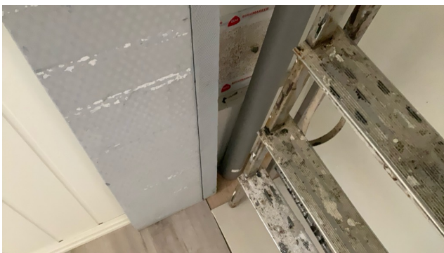
Manglende ildfast plate på gulv ved feieluke
