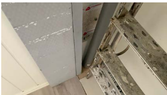
Manglende ildfast plate på gulv ved feieluke
