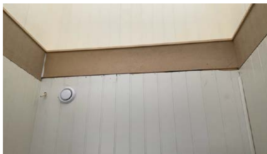
Trapperom etablert våren 2026, trapp ikke montert ved befaringen.
