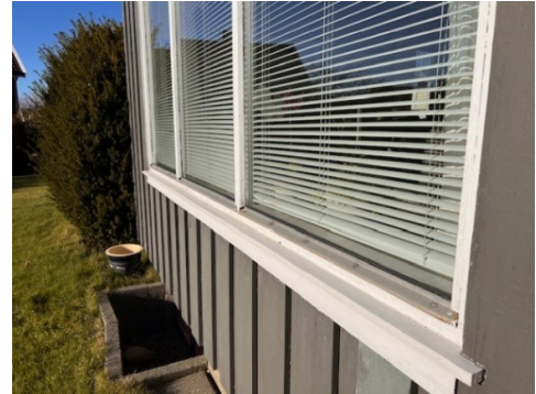
Råteskader i vinduer.
