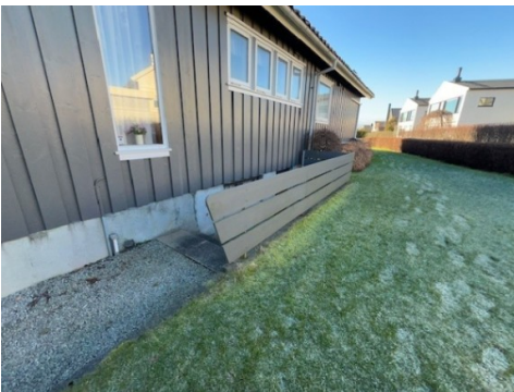
Rekkverk rundt kjellertrapp er for lavt.
