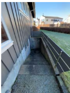
Kjellertrapp mangler håndløper på hver side i trapp.
