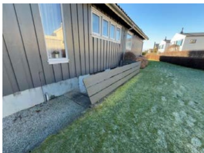
Rekkverk rundt kjellertrapp er for lavt.
