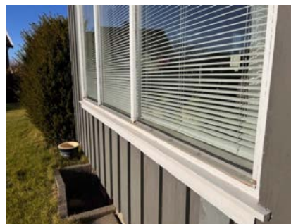
Råteskader i vinduer.
