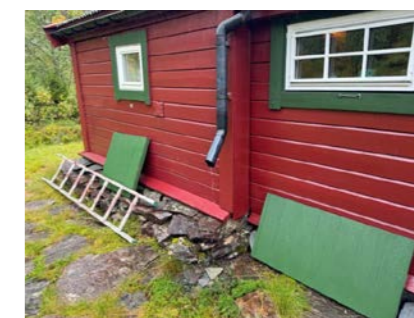
Bilde viser eksempel på nedløpsrør som ikke er videre drenert i grunnen.
