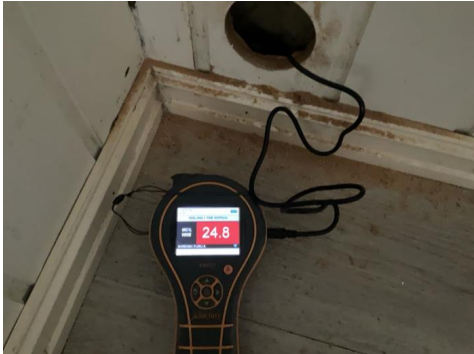
Fuktmåling i vegg i soverom i leilighet.
