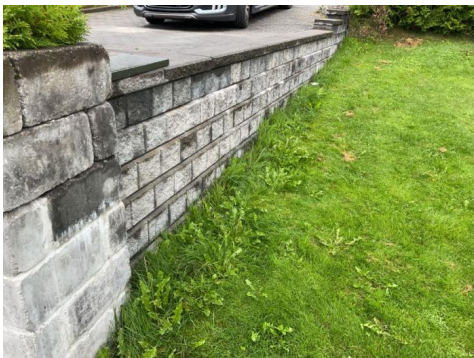
Støttemur uten sikring.
