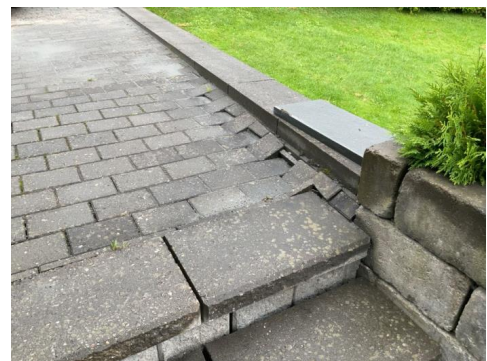
Noe setninger i belegningsstein.
