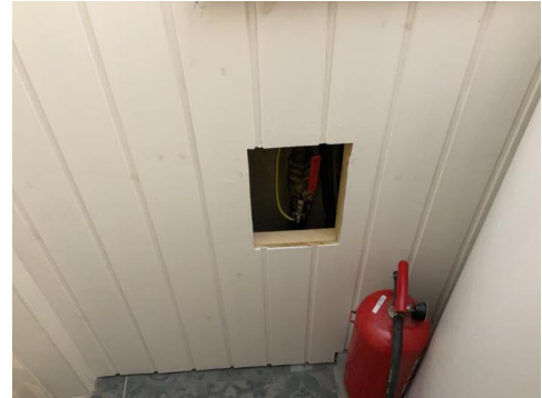
Stoppekran i vegg i vaskerom.
