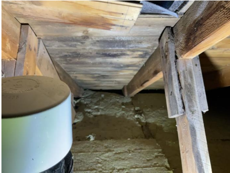
Noe misfarging på undertak ved lufting.
