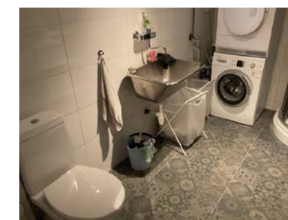
Vaskerom i kjeller til hoveddel.
