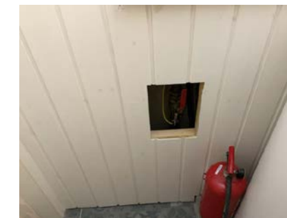
Stoppekran i vegg i vaskerom.
