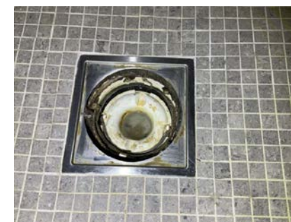
Sluk i dusjsonen.
