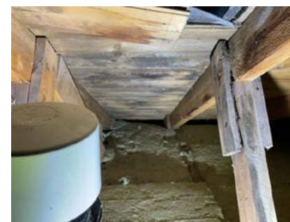
Noe misfarging på undertak ved lufting.
