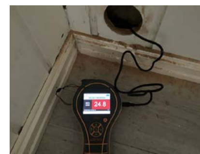
Fuktmåling i vegg i soverom i leilighet.
