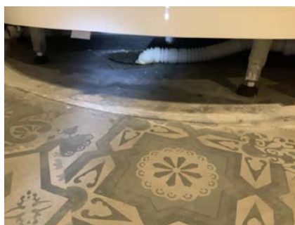
Sluk under dusjkabinett.
