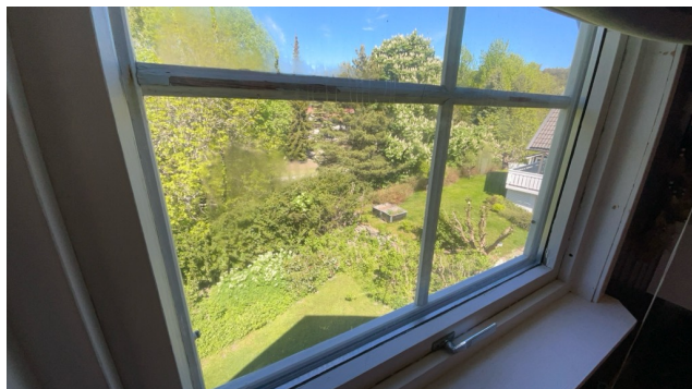
Flere punkterte vinduer.
