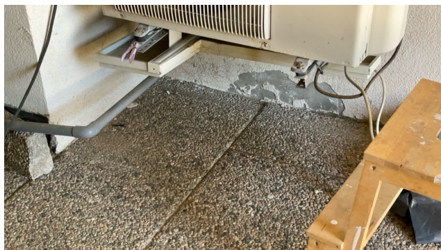
Mindre løs puss under varmepumpe.
