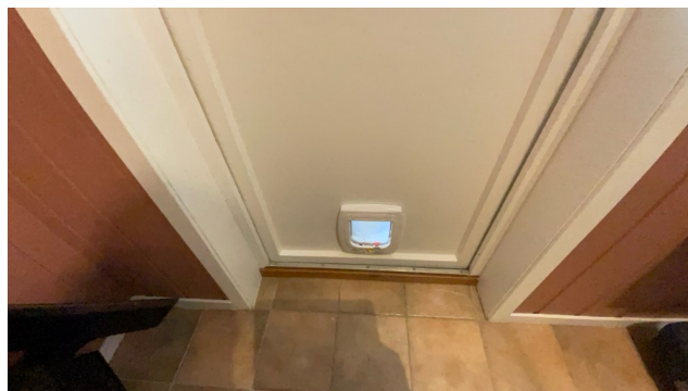
Katteluke i dør i gang.
