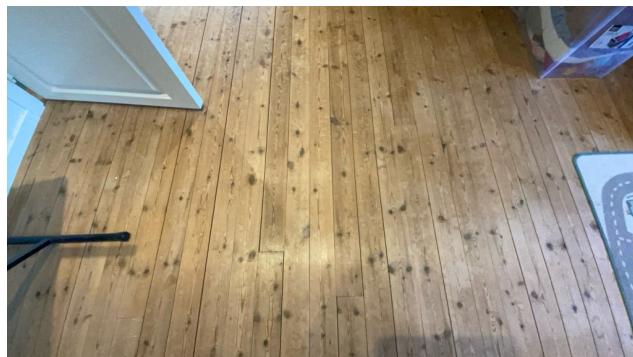
Skjolder og en del sprekker mellom gulvbord.
