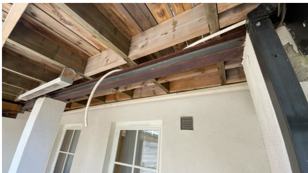
Noe rust ses på jern drager.
