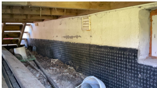
Noe løs overflatebehandling under trapp/veranda.
