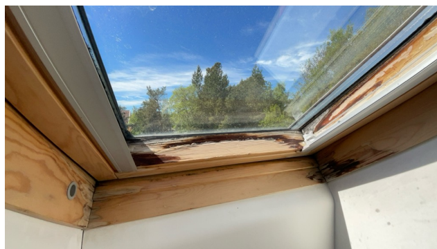
Fuktskader på trevirke
