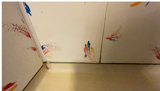
Fuktskader i nedre del.
