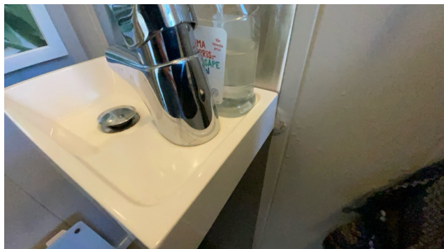
Fukt skader på vegoverflate ved servant.
