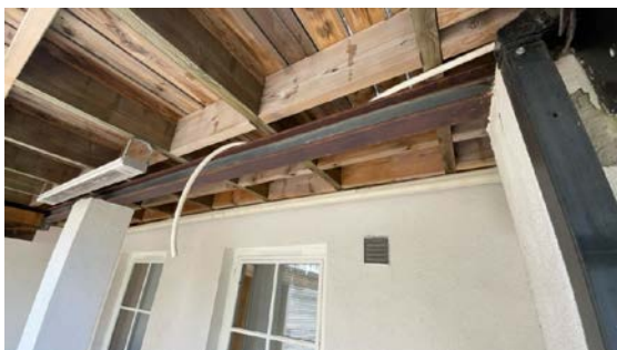
Noe rust ses på jern drager.
