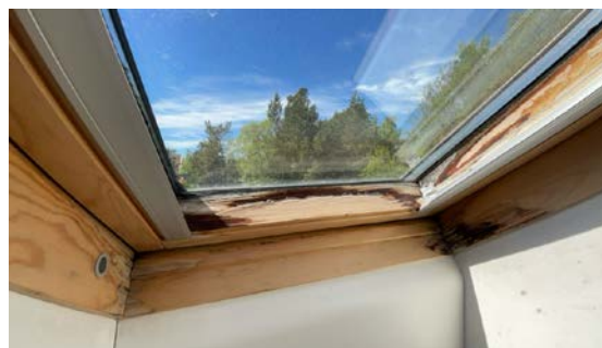
Fuktskader på trevirke
