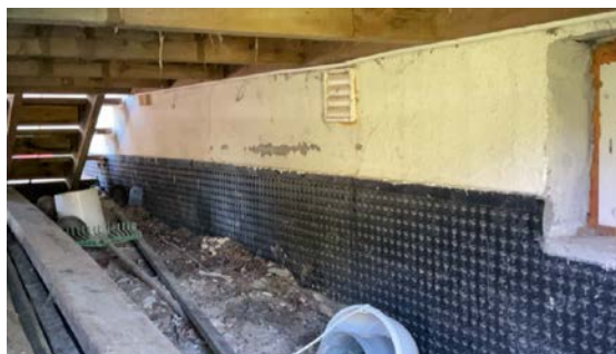
Noe løs overflatebehandling under trapp/veranda.
