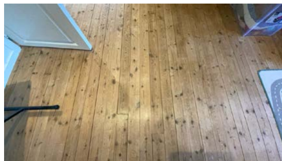
Skjolder og en del sprekker mellom gulvbord.
