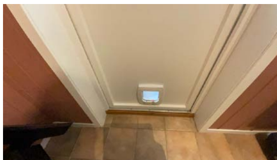
Katteluke i dør i gang.
