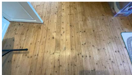
Skjolder og en del sprekker mellom gulvbord.
