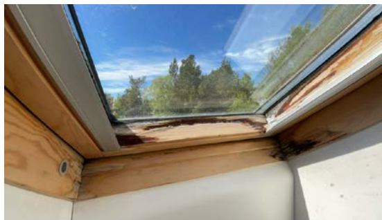
Fuktskader på trevirke
