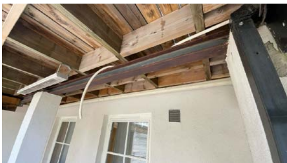
Noe rust ses på jern drager.
