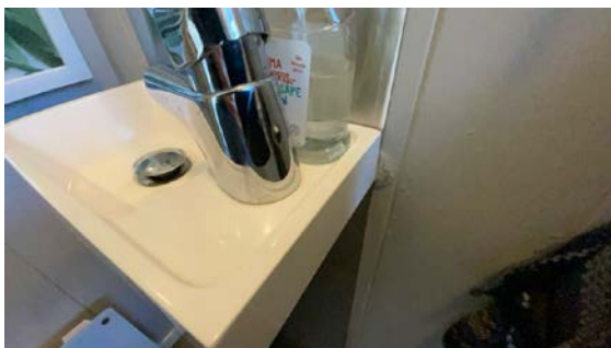
Fukt skader på vegoverflate ved servant.
