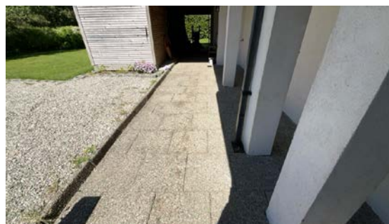
Avvik i terreng fra boligens grunnmur- terreng justering må utføres.
