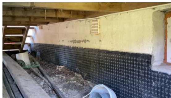
Noe løs overflatebehandling under trapp/veranda.
