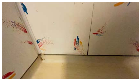
Fuktskader i nedre del.
