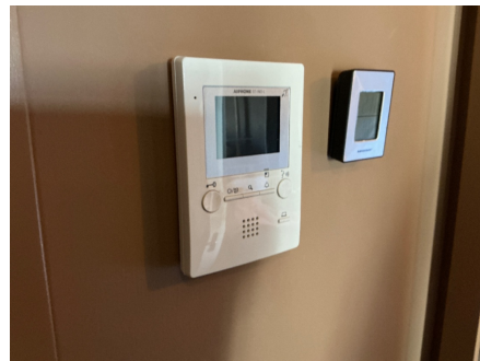
Dørcalling med monitor er plassert i gang.
