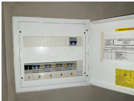
Automatsikringer i sikringsskap plassert i stue/kjøkken.
