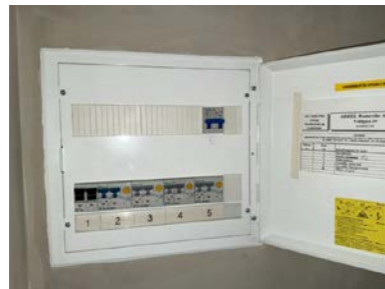
Automatsikringer i sikringsskap plassert i stue/kjøkken.
