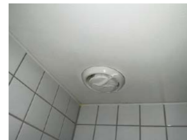
Kontroll av avtrekk.
