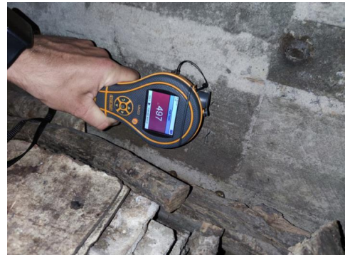
Indikert fukt i vegg mot øst.
