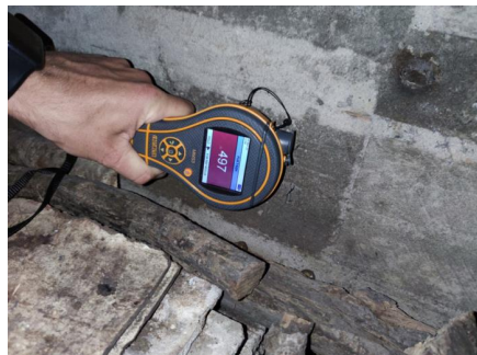
Indikert fukt i vegg mot øst.
