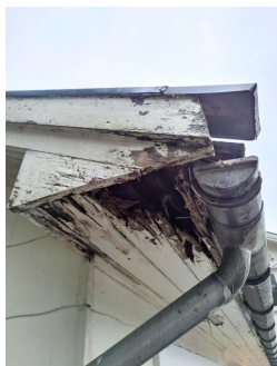
Råteskadet forkantbord og gesimskasse.
