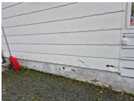
Skader på veggplater.
