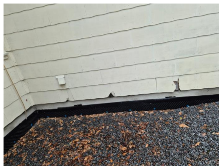
Skader på veggplater.
