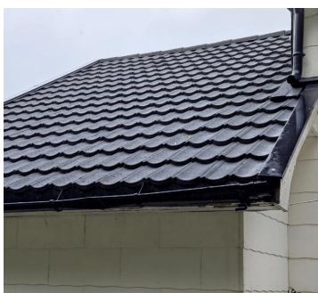
Deformasjoner i takrenne.
