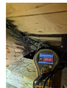
Det ble målt høye fuktverdier i undertak.
