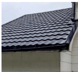
Deformasjoner i takrenne.
