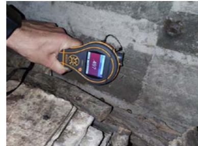
Indikert fukt i vegg mot øst.
