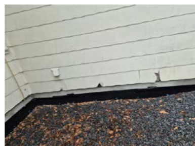
Skader på veggplater.
