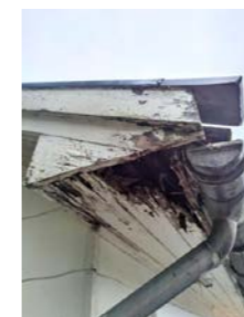
Råteskadet forkantbord og gesimskasse.
