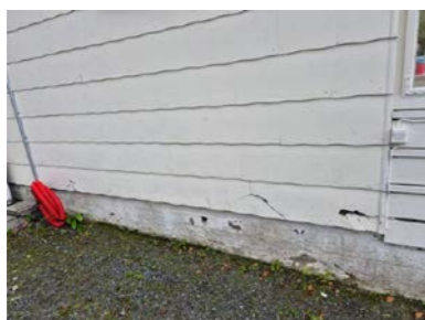
Skader på veggplater.
