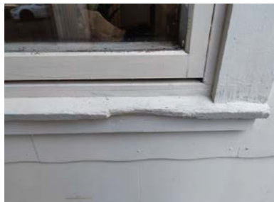
Råteskadet vannbrett til kjøkkenvindu.
