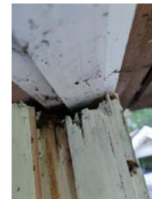
Råteskadet ramme til balkongdør.
