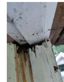
Råteskadet ramme til balkongdør.
