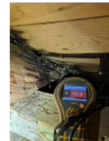
Det ble målt høye fuktverdier i undertak.
