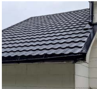
Deformasjoner i takrenne.
