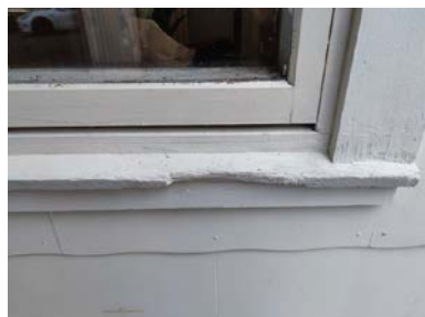
Råteskadet vannbrett til kjøkkenvindu.
