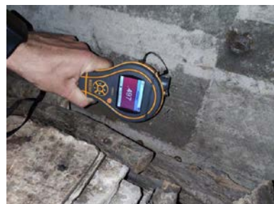
Indikert fukt i vegg mot øst.
