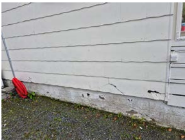
Skader på veggplater.
