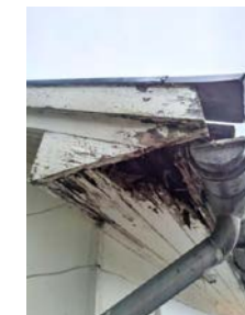
Råteskadet forkantbord og gesimskasse.
