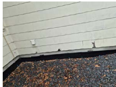
Skader på veggplater.
