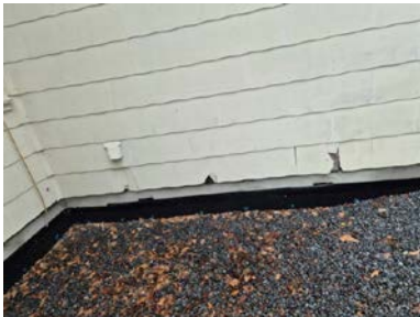
Skader på veggplater.
