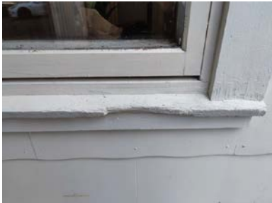
Råteskadet vannbrett til kjøkkenvindu.
