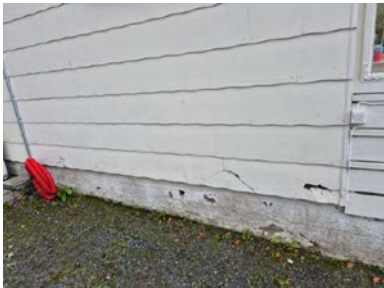
Skader på veggplater.
