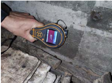
Indikert fukt i vegg mot øst.
