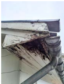
Råteskadet forkantbord og gesimskasse.
