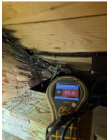
Det ble målt høye fuktverdier i undertak.
