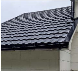
Deformasjoner i takrenne.
