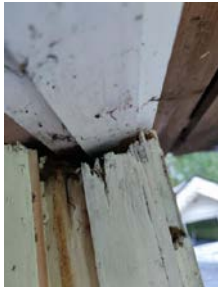
Råteskadet ramme til balkongdør.
