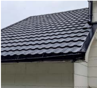
Deformasjoner i takrenne.
