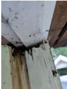
Råteskadet ramme til balkongdør.
