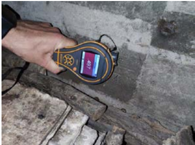
Indikert fukt i vegg mot øst.
