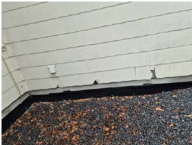
Skader på veggplater.
