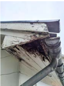
Råteskadet forkantbord og gesimskasse.
