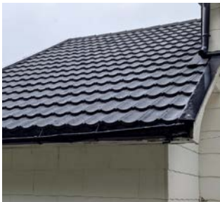
Deformasjoner i takrenne.
