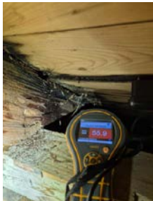
Det ble målt høye fuktverdier i undertak.
