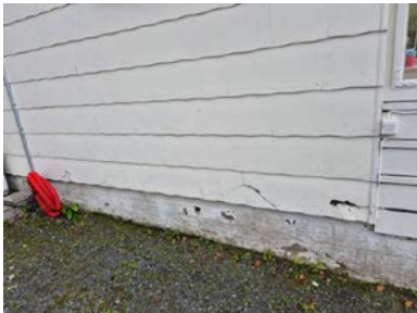
Skader på veggplater.
