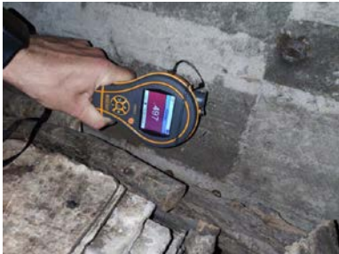
Indikert fukt i vegg mot øst.
