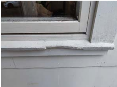
Råteskadet vannbrett til kjøkkenvindu.
