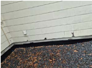
Skader på veggplater.
