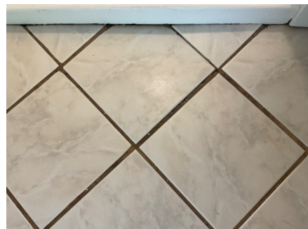
Flisgulv har noe skade.
