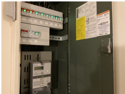
Sikringskap i trappegang.
