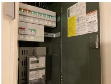
Sikringskap i trappegang.
