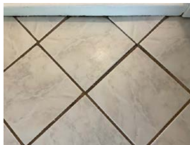
Flisgulv har noe skade.
