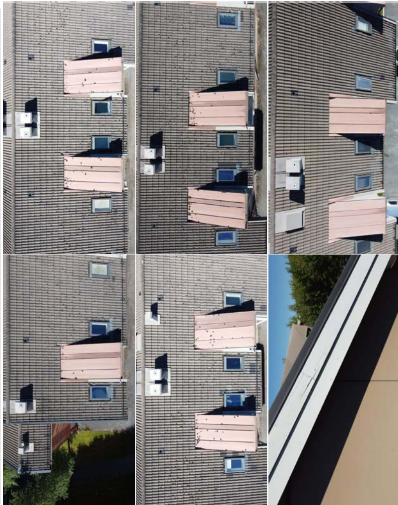
Bilde av knekt takstein og mose på taket, samt tegn til røte på enkelte vindskjjer.
