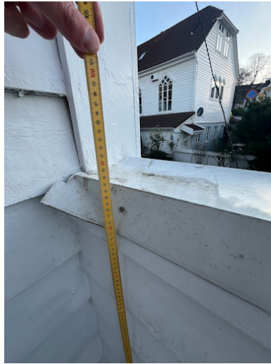
Skade på beslag, for lav høyde
