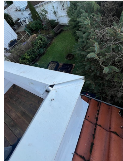
Skade på beslag
