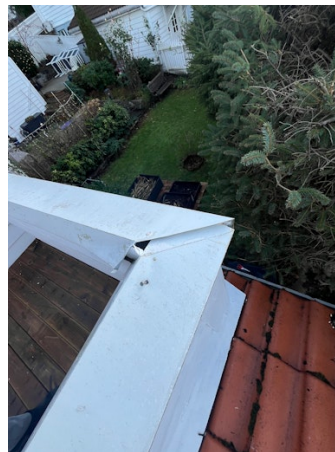
Skade på beslag
