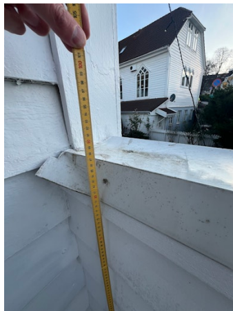
Skade på beslag, for lav høyde
