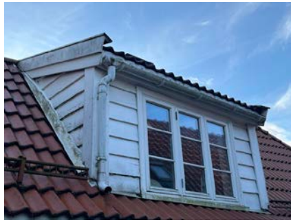
Registreres noe etterslep på vedlikehold,
