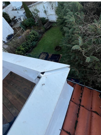
Skade på beslag
