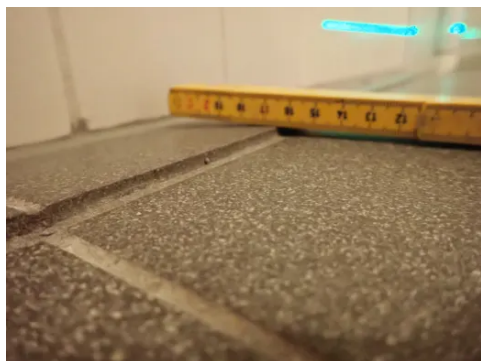
Fliser som vipper og har løsnet.
