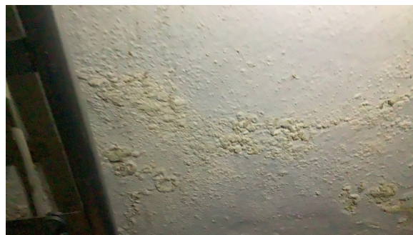
Eksempel på saltutslag på grunnmur.
