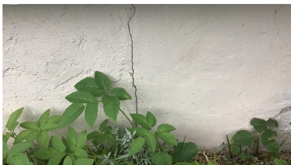
Eksempel på utvendig skråriss.
