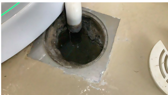
Støpejernsluk, og det er ikke tett tilslutning mellom et eventuelt tettesjikt og sluk
