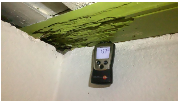
Tidligere råteskader måles tørre.
