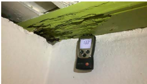
Tidligere råteskader måles tørre.
