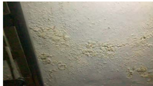
Eksempel på saltutslag på grunnmur.
