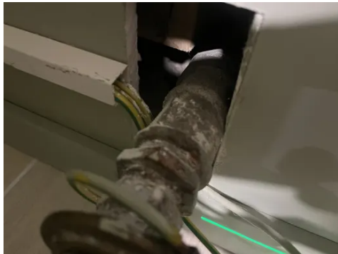
Bruk av fotlist og åpning overgang vegg/ gulv.
