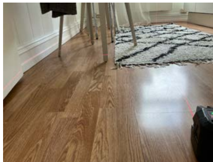
Nivellering kjøkken, avvik ca. 15-30 mm
