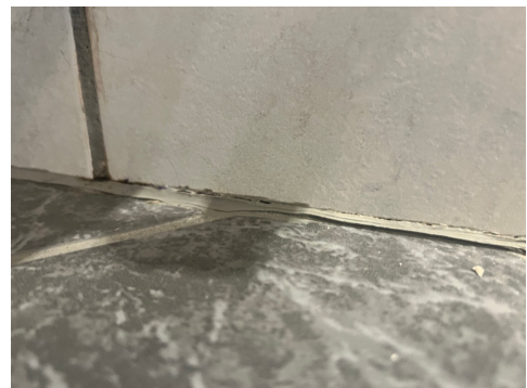
Sprekk i silikonfuge overgang gulv/vegg.
