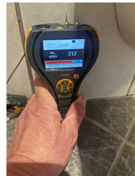
Fukt i vegg ved siden av toalett
