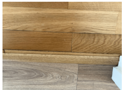
Sprekk i langsgående skjøt
