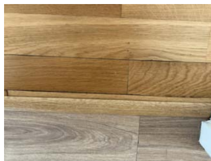
Sprekk i langsgående skjøt
