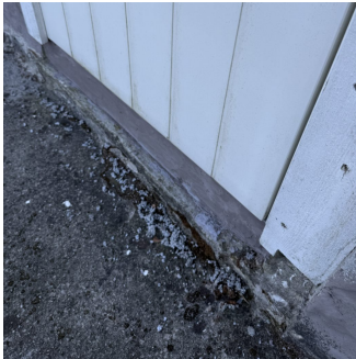
Mangler beslag og fuktskade dør u.etg
