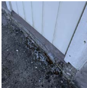
Mangler beslag og fuktskade dør u.etg
