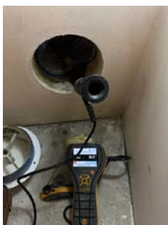
Fuktsøk i utforet vegg viser høyt fuktnivå
