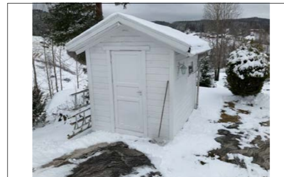
Bod/hundehus i trekonstruksjon på eiendommen. Bygningen har vesentlige skjevheter.
