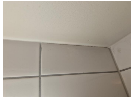
Sprekker i fuger mot tak.
